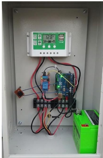
Gambar 4. 2 Sistem Kelistrikan Pada Panel
